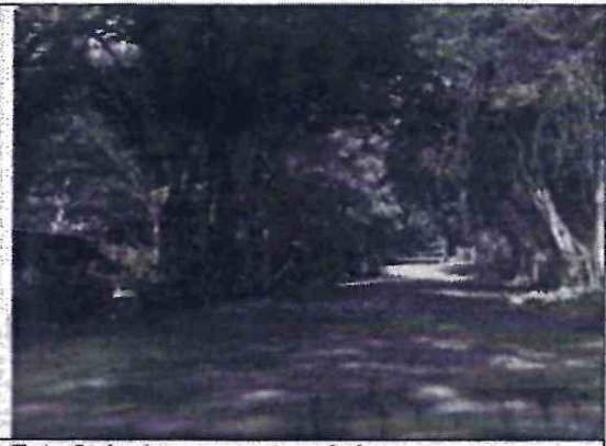
Foto 2.-Azolve en carretera, lodos
